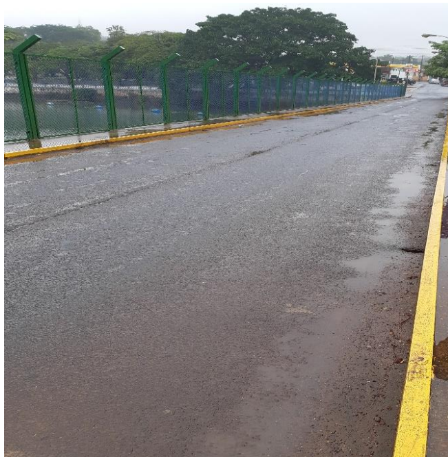
Figura 5 – Pavimento da ponte a ser recuperado
